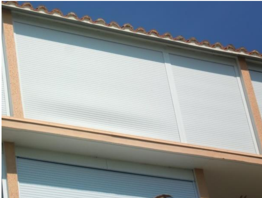
Figure 2 – Bombement du tablier d'un volet roulant
