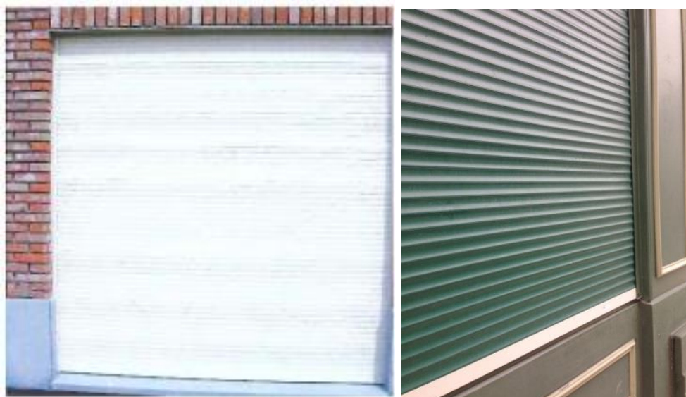
Figure 1 – Ondulation de tabliers de volets roulants
